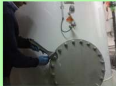
Desmontando un acumulador para acceder a su interior
