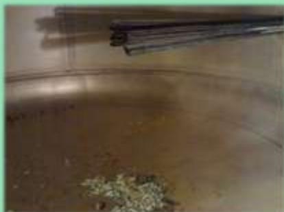
En los acumuladores se encuentran restos de incrustaciones calcares, idóneas para alimentar a la bacteria
