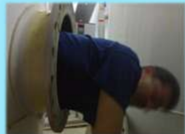
No siempre se puede acceder al interior de los acumuladores.
